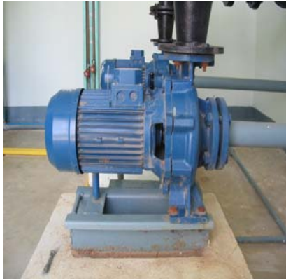
(2) โรงสูบน้ำดิบ
